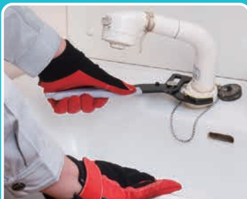
洗面所・トイレの水漏れ
